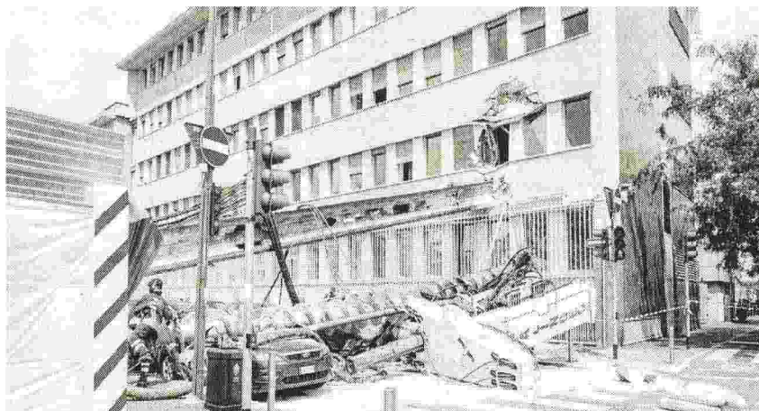
Via Serio, gru precipita e danneggia l'Ifom di Milano / Fotogramma
